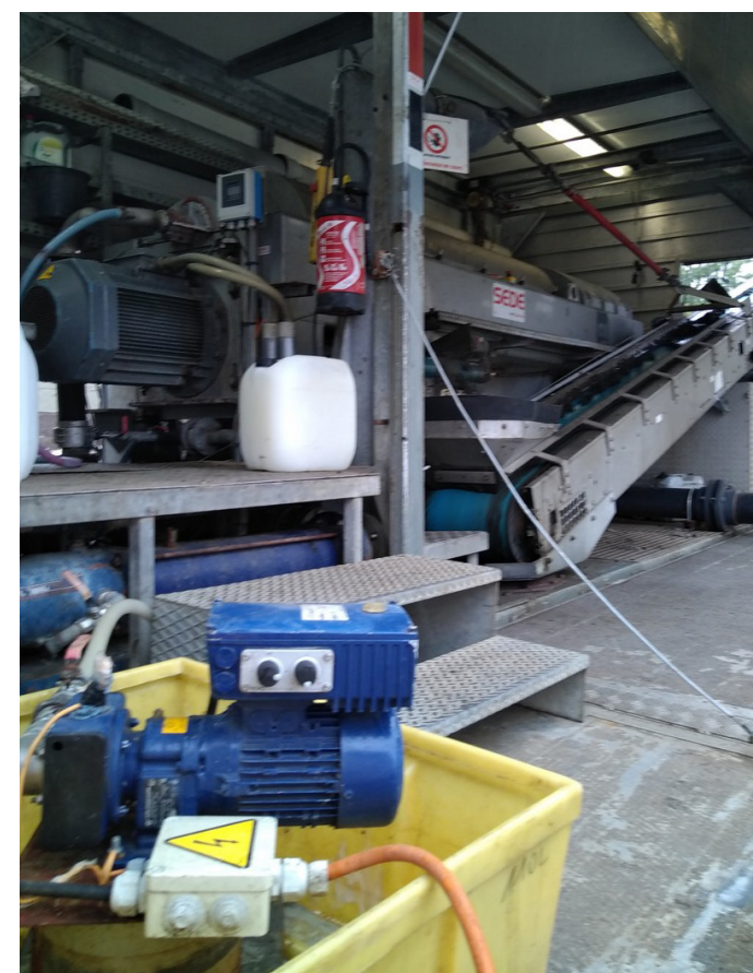
Après floculation, les boues sont déshydratées par la centrifugeuse (Crédit photo CCSSOM)
